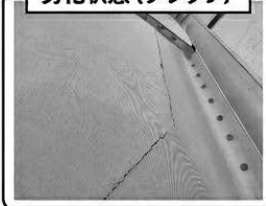
劣化状態（クラック）
